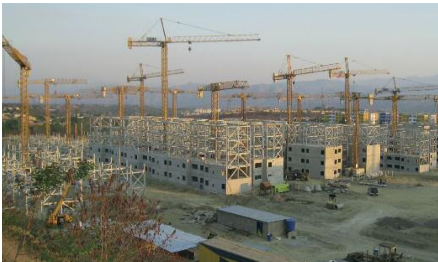
Budownictwo jest jednym z głównych obszarów zainteresowania ArcelorMittal w roku 2015. Grupa ArcelorMittal dostarczyła 13 500 ton stali z hut w Olaberria i Bergara (Hiszpania) na budowę budynków socjalnych w Wenezueli.
